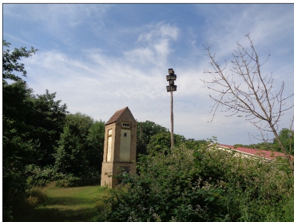
Abb. 19: Altes Trafohäuschen und Vogelnistkästen
