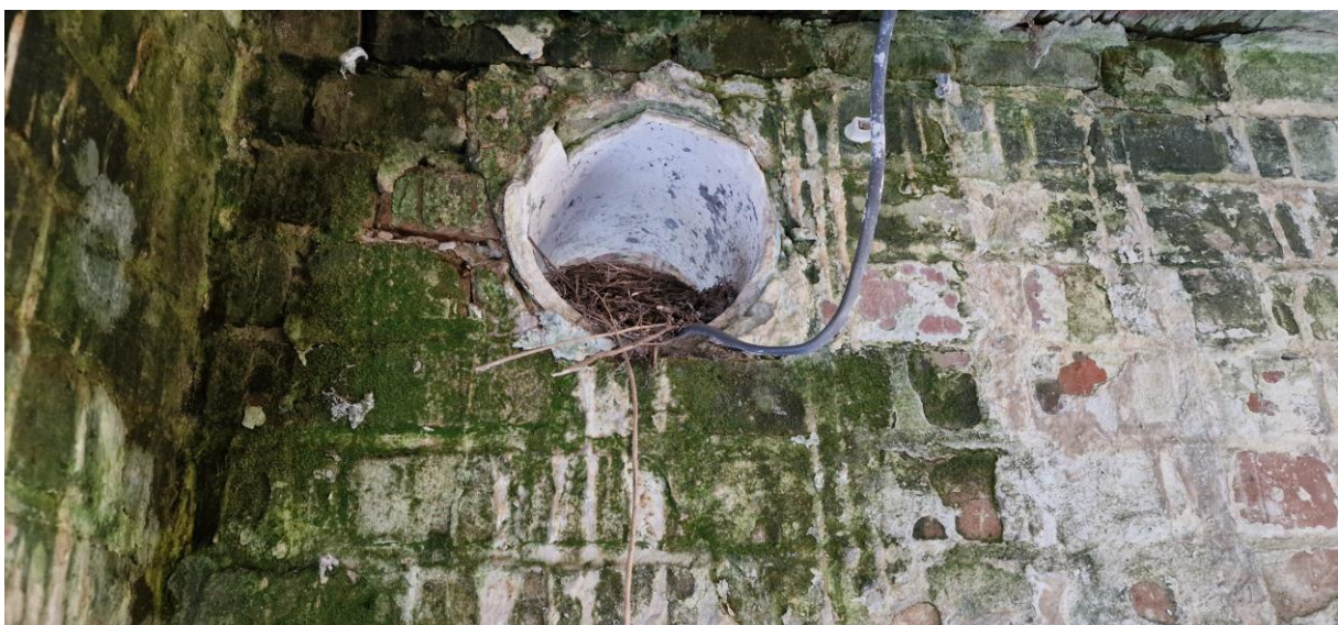
Abbildung 35: Hausrotschwanznest in Tonröhre in Gebäude 2.
