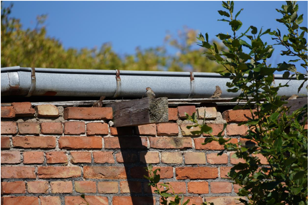
Abbildung 44: Haussperlinge an den defekten Dachbereichen von Gebäude 2.
