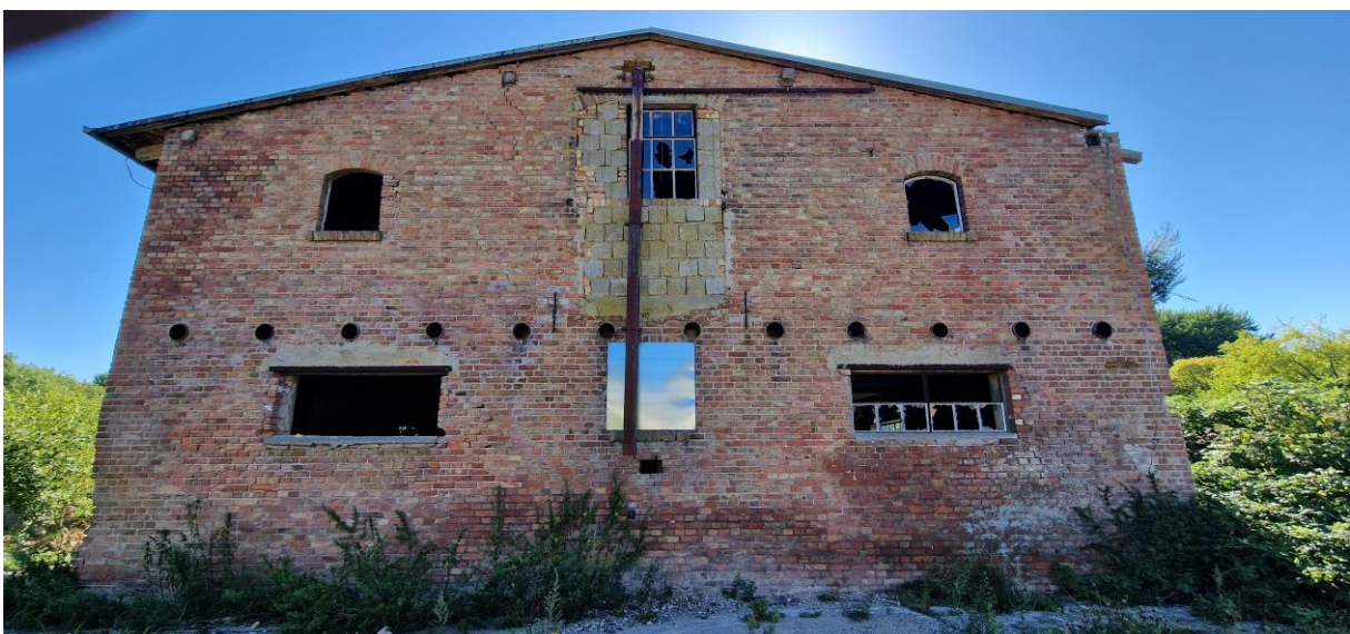
Abbildung 17: Nordostgiebel des Gebäudes 2 mit zahlreichen Spalten.
