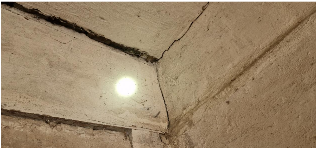
Abbildung 16: Kotschäden an der Wand in Gebäude 3.
