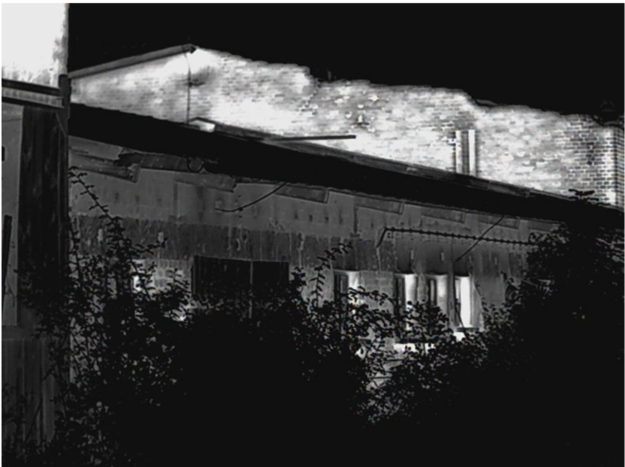
Abbildung 49: Südwestseite von Gebäude 1 im Wärmebild.
