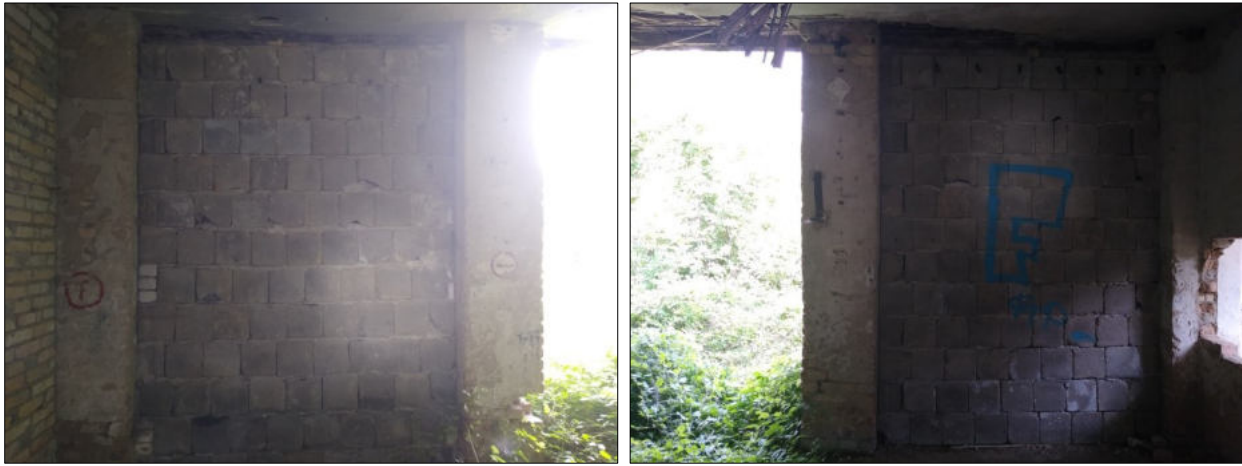
Abb. 58 u. 59: Innenwandbereiche im südwestlichen Gebäudeteil (Garagenanbau) mit etlichen als Winterquartier geeigneten Hohlräumen und Spalten.
