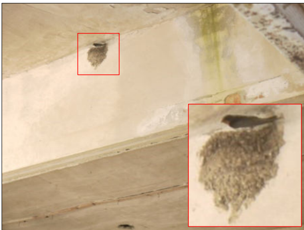
Abb. 70 u. 71: Nester der Rauchschalbe (Viereck) im Gebäude.
