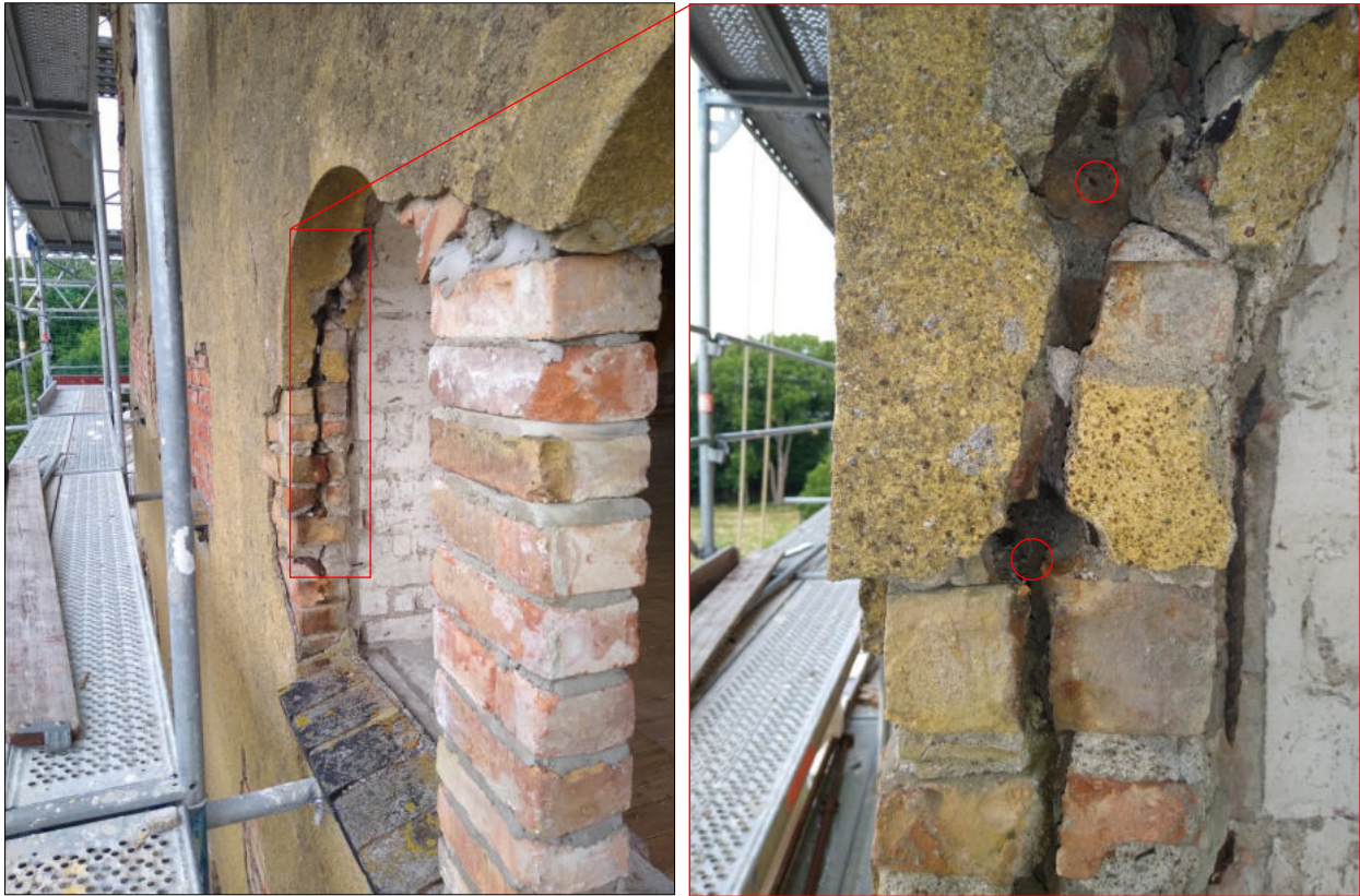
Abb. 45 u. 46: Riss im Mauerwerk der Außenfassade des Speichertraktes mit geringumfänglicher Kotablagerung sowie Anhaftung einiger Kotpellet (Kreise) einer Fledermausart der Gattung Pipistrellus .
