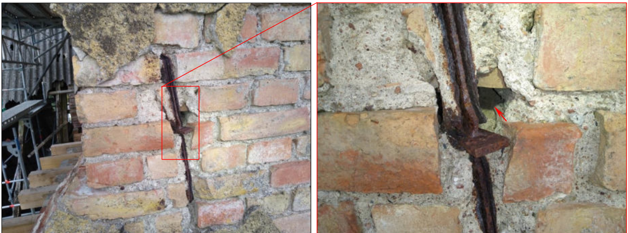
Abb. 47 u. 48: Einschlupf (Pfeil) zu einem als Quartier genutzten Hohlräume im Mauerwerk im Bereich eines Wandankers am Speichertrakt.
