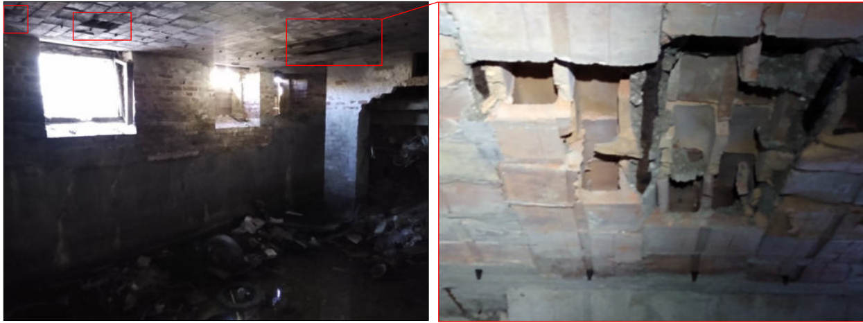
Abb. 15 - 18: Keller des Speichertraktes. Die Fenster im Keller sind z.T. verschlossen, z.T. offen, der Keller somit relativ bewettert. Die Hohlziegeldecke weist einige, klassisch als Fledermauswinterquartier fungierende Schadstellen auf (siehe Rechtecke). Der Wasserstand im Keller wechselt je nach Jahreszeit.
