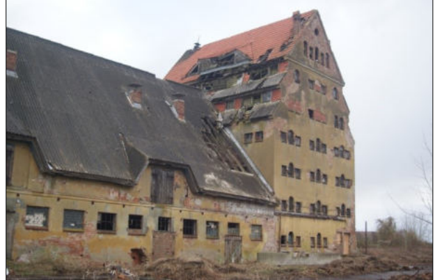
Abb. 4: Stallspeicher mit desolater Dacheindeckung.
